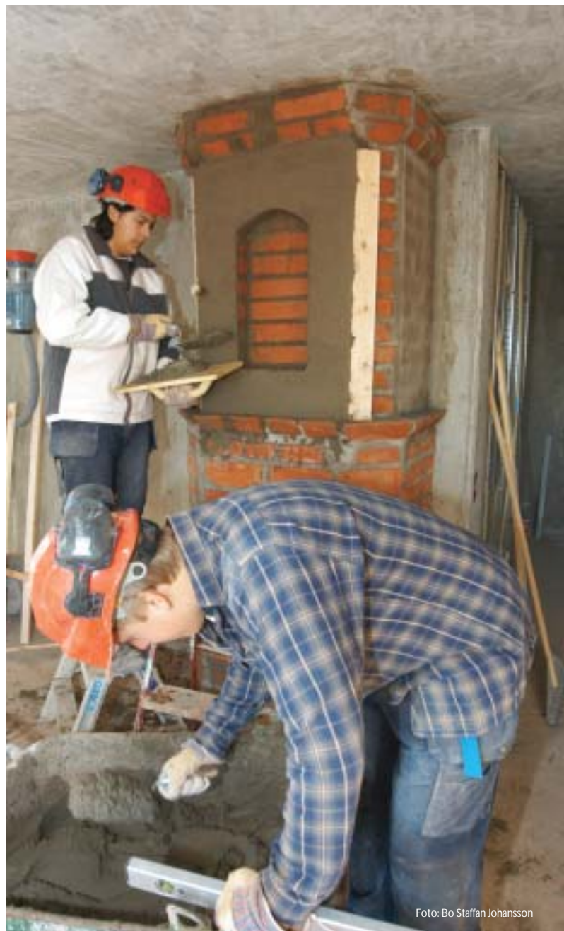
Elevbyggen, här i form av hyreshus åt PiteBo efter Nygatan, ger eleverna på byggprogrammet vid Strömbackaskolan chansen att träna sina praktiska färdigheter.
