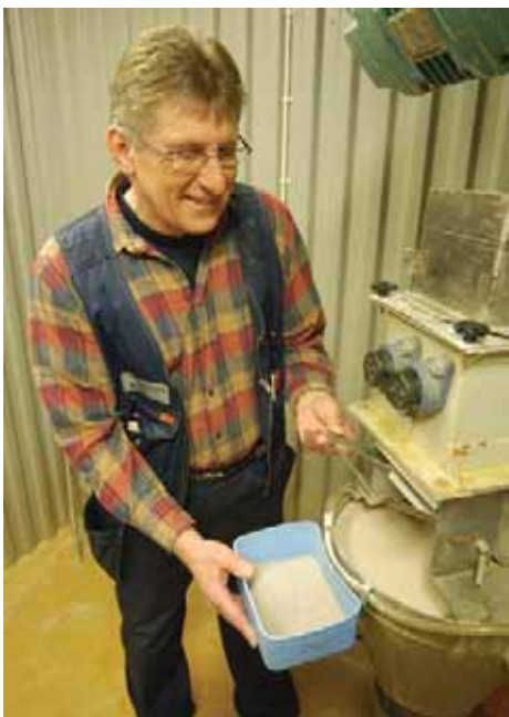
Dan Burström kontrollerar doseringen av reningskemikalien aluminiumsulfat.
