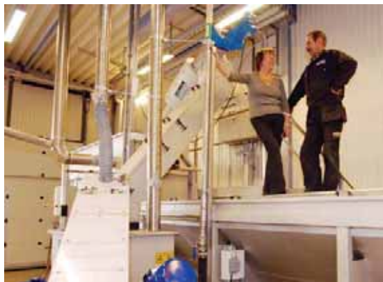
Anita Larsson och Ulf Öhlund vid den nya utrustningen för mottagning av externslam från privata VA-anläggningar och små avloppsreningsverk.
