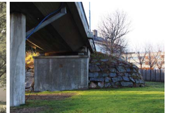
Bild på Sjukhusbron. Släpljus på pelarstöden kan bredda rummet och det kan upplevas tryggare.
