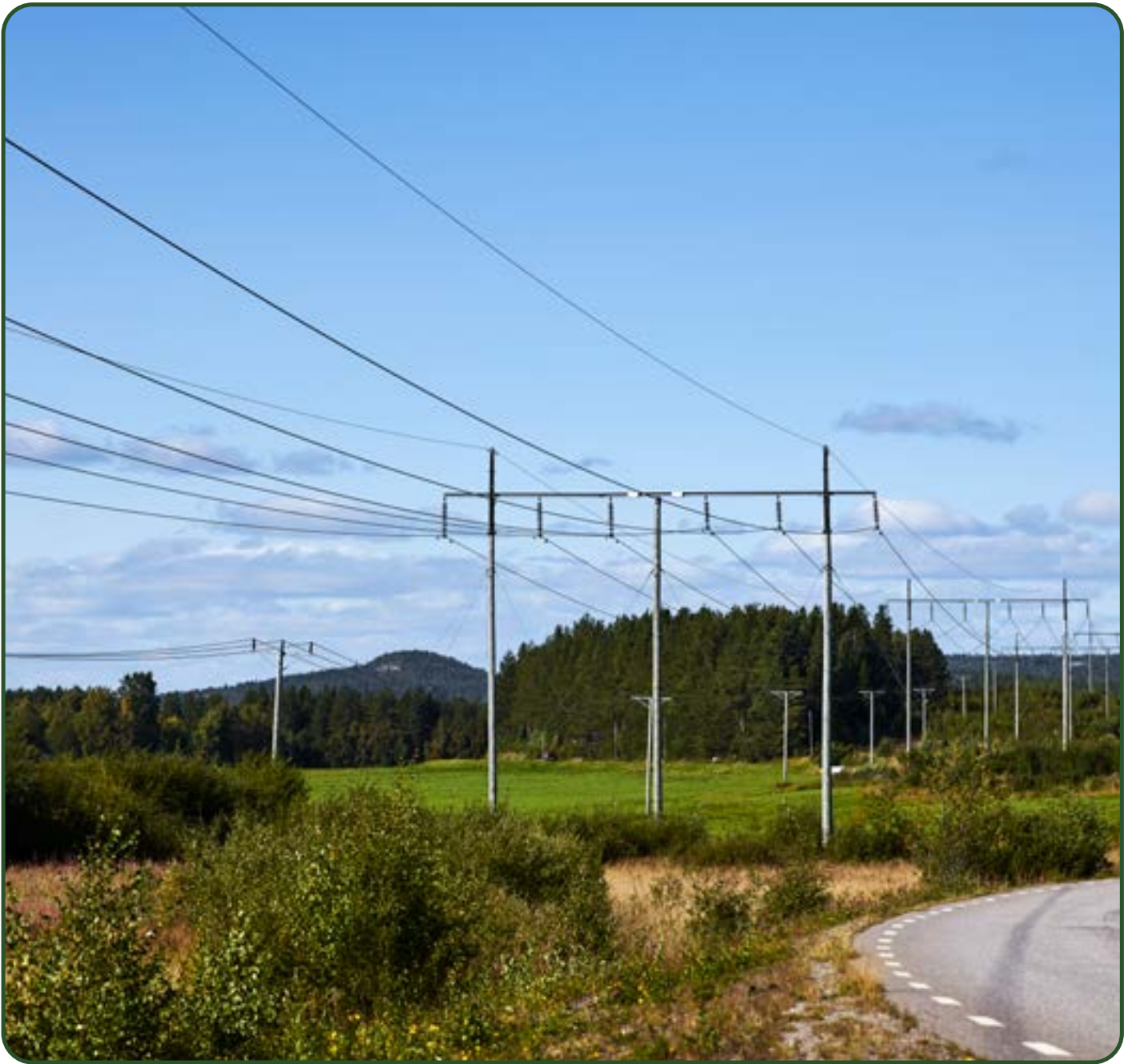
Elnätet i Munksunds stadsdelscentrum har i dagsläget ca 1350 elabonnenter. Foto: Maria Fäldt.
